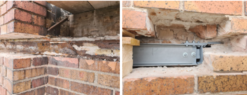
Korrodierte und ersetzte Stahlträger des Turms Fotos: 2B Planungsgesellschaft
